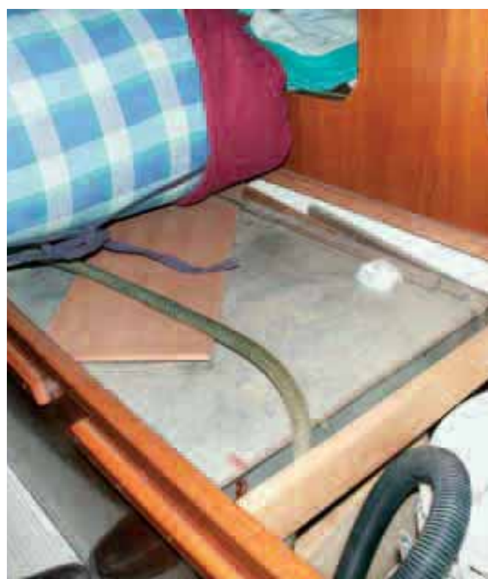
In basso un serbatoio in acciaio con anodo sacrificale
